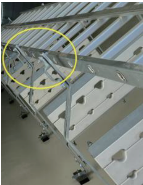
线缆支架未固定到爬梯上时不能踩！
